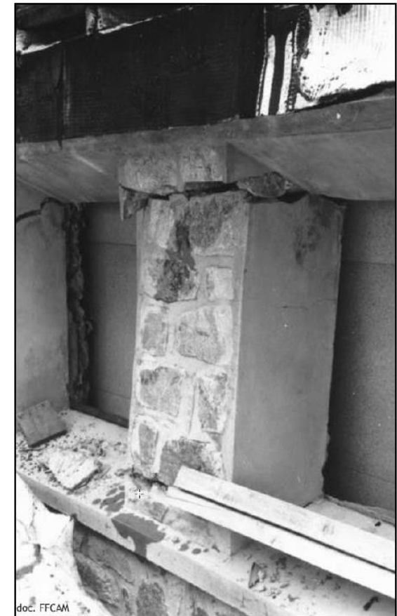
Figure 23 – Vue d'un pilier entre 2 fenêtres du 2 ème étage (présence visible de l'étanchéité) après déneigement
